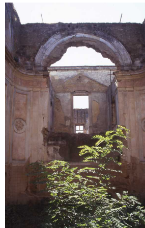
Figura 7 - Um aspeto do interior em ruínas da capela do Palácio do Farrobo, Vila Franca de Xira, desconhecido, 1982, Col. Museu Municipal de Vila Franca de Xira.
