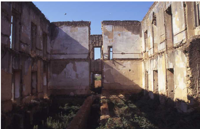
Figura 6 - Um aspeto do interior em ruínas do Palácio do Farrobo, Vila Franca de Xira, desconhecido, 22 de fevereiro de 2006, Col. Museu Municipal de Vila Franca de Xira.
