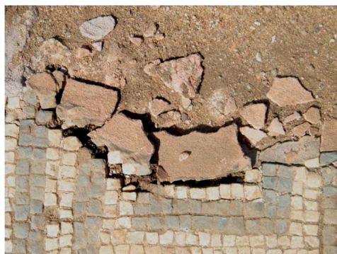
Fig. 8 – Deterioração de intervenções anteriores.
