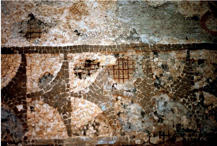
Fig. 2 - Orla del mosaico de Dédalo y Pasifae . Se puede observar la profundidad de la pérdida de teselas, dejando a la vista el entramado metálico del soporte de cemento.
