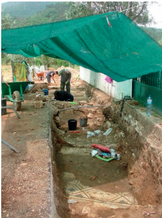
Fig. 2 - Aspecto geral da vala aberta para implantação do saneamento onde foram identificadas diversas estruturas, mosaicos e sepulturas (Fotografia: Sónia Vicente, 2015)
