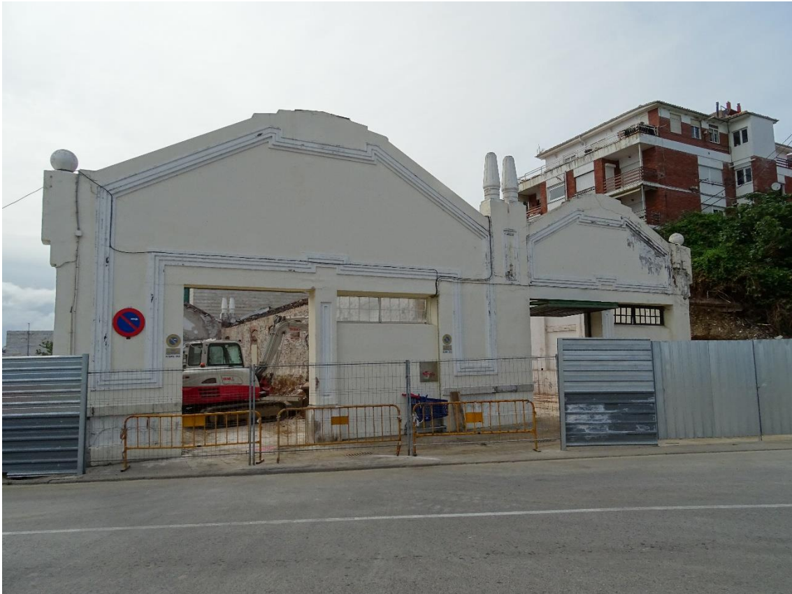
Fig. 5 Naves de Gamazo (perspectiva este) en proceso de rehabilitación. Foto: Luis Walias Rivera, junio de 2019.
