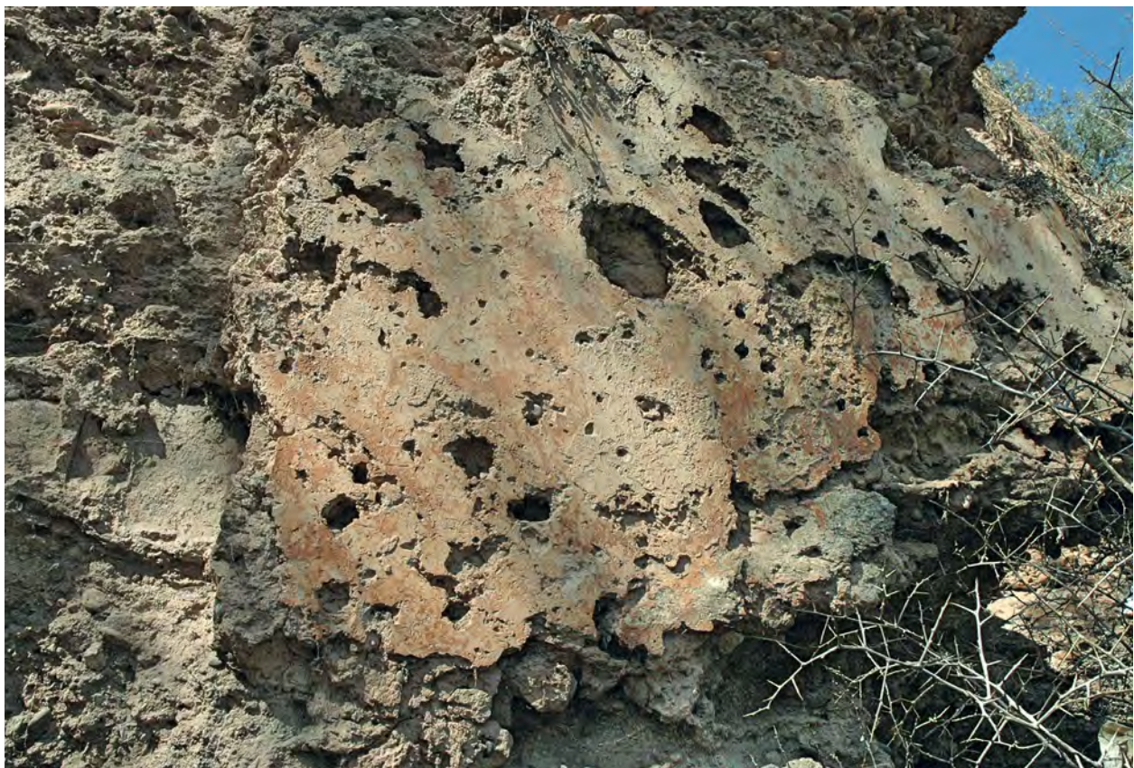
Fig. 12 – Detalhe do paramento externo do troço mais bem conservado da muralha em taipa, vendo-se o seu reboco. Detaille de la surface externe de la partie de la muraille en pisé la mieux préservée, s'observant le plâtre.
