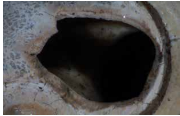
5. Fisuras en el contorno de la perforación.
