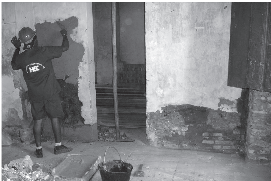
2. Desmonte e restauração de reboco sem leitura estratigráfica.
