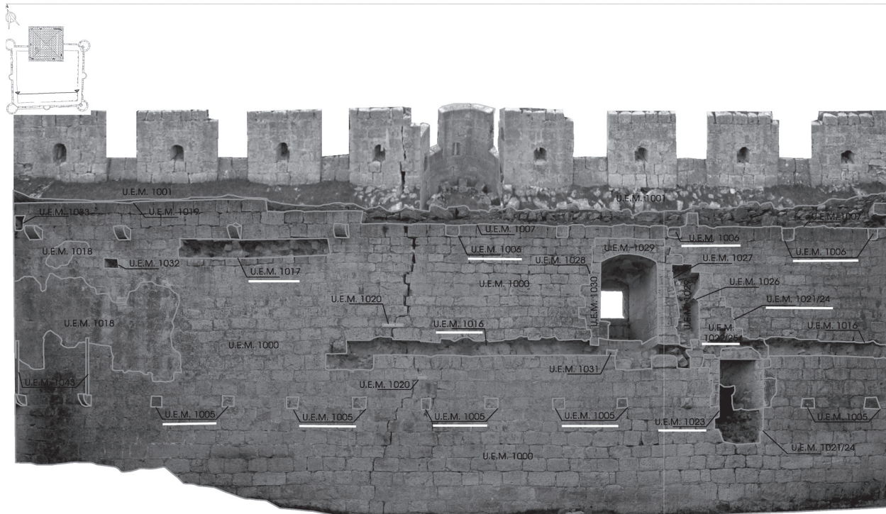
7. Interior de la fortaleza. Vista fotogramétrica del muro sur donde se señalan las Unidades Estratigráficas Murarias que la componen. Se identifican las roturas de las ménsulas (UEM 1005 y 1006) que servían a la construcción bajomedieval. También se observan las cámaras de tiro construidas (UEM 1021/24, 1022/25 y 1023) para adaptar el castillo a las necesidades de la artillería. Las rozas (UEM 1016 y 1017) y las ventanas de asiento responden a las modificaciones palaciegas del siglo XVI.
