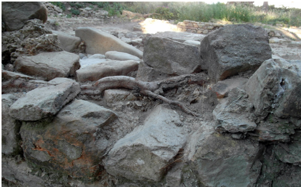
115. Désagrégation du mortier provoquée par une racine de grande taille dans le mur qui délimite la maison islamique à l'Ouest (n.º308) du secteur E17N10-E18N10-E18N9, en 2014.
