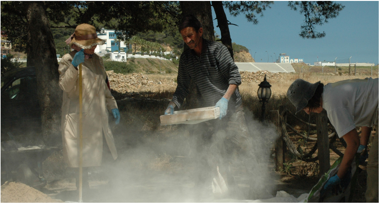
121. Fabrication du mortier pour la restitution des murs de la maison Est (n.º308) du secteur E17N10-E18N10-E18N9, en 2014.
